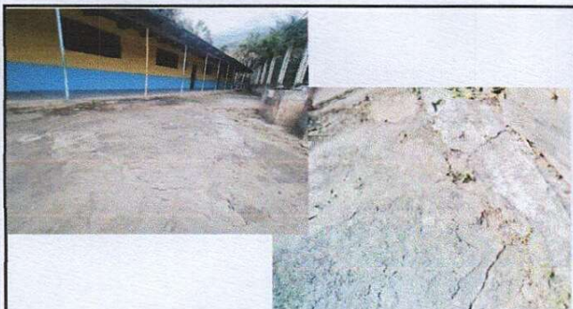
Foto 3: La losa de patio se ha rajado y tiene hundimientos que ocasionan empozamientos de agua generando peligro para los niños en su área de recreación.
