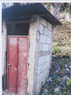
Foto 2: Las puertas de servicios sanitarios ya no cumplen con su funcionamiento.
