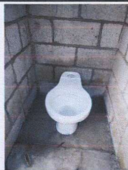
Foto 4: Los sanitarios ya no realizan un correcto funcionamiento, no cuentan con tanque ni sistema de desagüe, teniendo solo las tazas y están rajadas.
